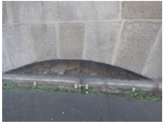
FIG 13.2. estos de instalaciones en desuso y escombros.
