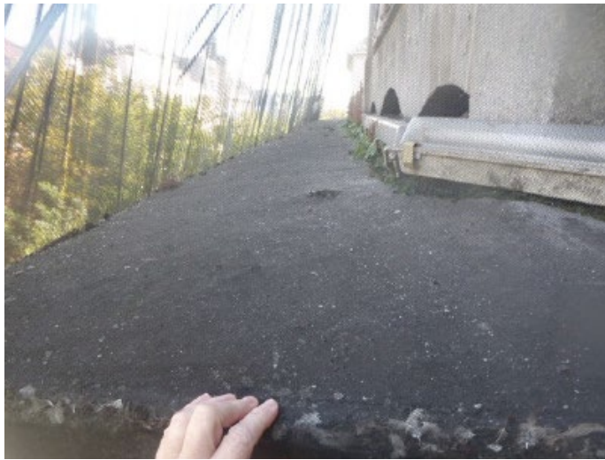
FIG 13.1. Impermeabilización envejecida y defectuosa.
