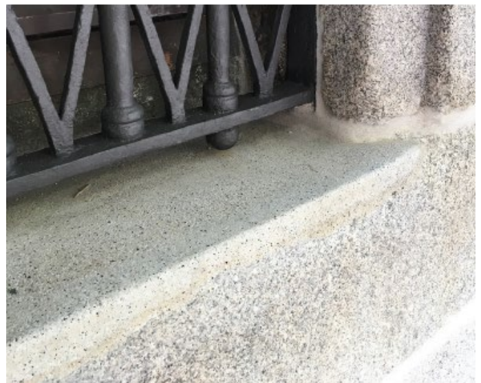
FIG 15. Alféizar: estado antes y después de la intervención.
