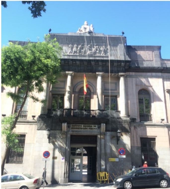
FIG4. Portada con la red de protección en balcón y coronación (2016).
