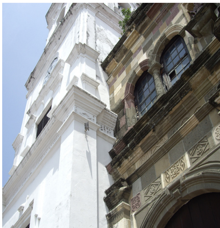
12. Pérdida de material en fuste de columna de galería (2015).
