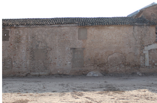
16. Huella de arcos en fachada oeste.
