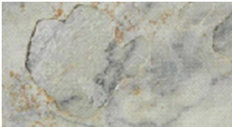
19. Exfoliación superficial en las placas de revestimiento marmóreo del podio en el frente escénico.
