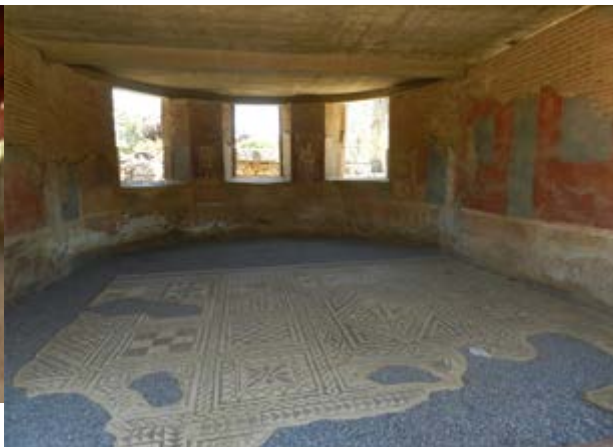
13. Daños en el zócalo de la habitación del tablinum, Casa Basílica, por el desvío de humedad hacia los muros laterales
