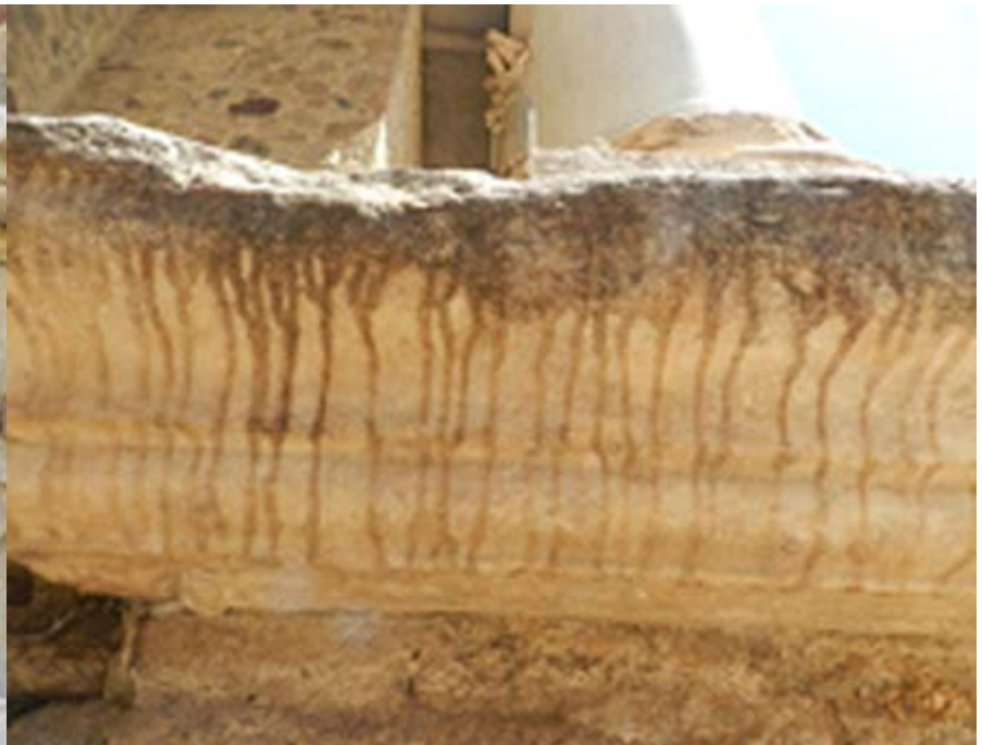
6. Marcas de escorrentías en las cornisas de mármol blanco, estas marcas son características de superficies tratadas con productos hidrofugantes (ICOMOS, 2008)
