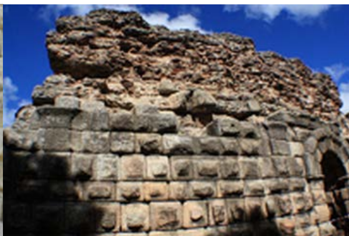
2. Ennegrecimiento y erosión de los sillares almohadillados de granito del perímetro exterior.
