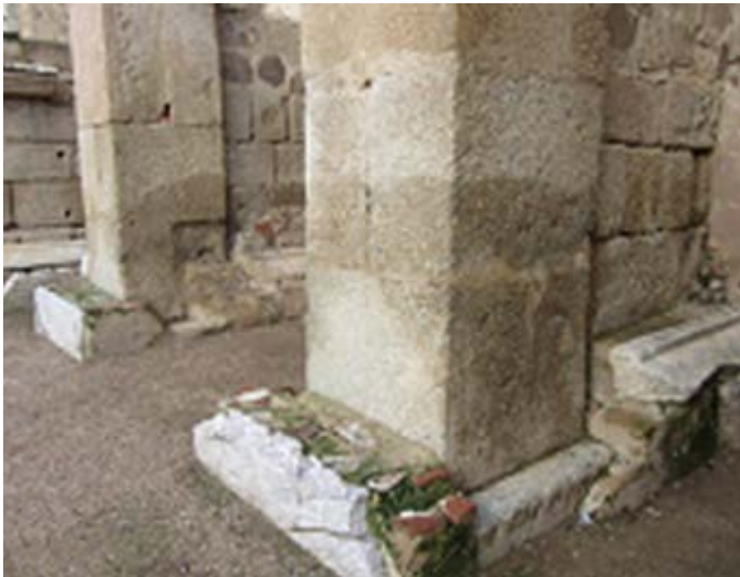
6 bis. Filtraciones de agua entre las juntas del basamento
