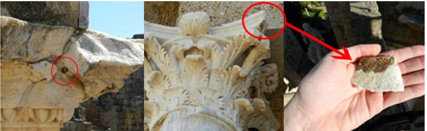
15. Fracturas en cornisas del orden superior por efecto de la oxidación de las grapas de hierro utilizadas como sistema de fijación al plinto.
