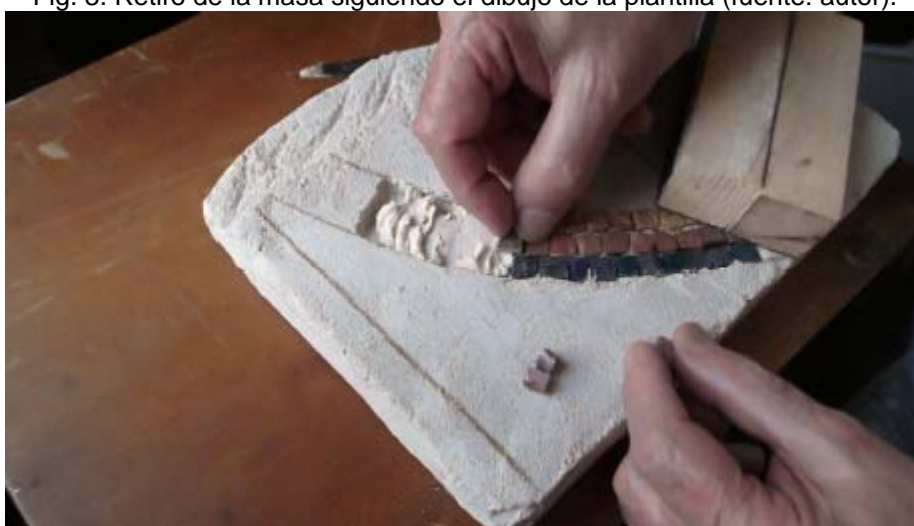
Fig. 4. Aplicación de la masa para el agarre de las teselas (fuente: autor).
