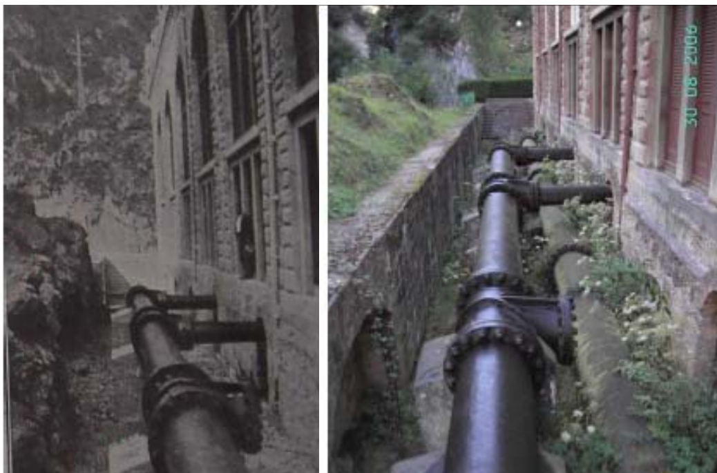
Fig. Izda: Tubo distribuidor suministrado por la casa Echer Wyss & Company, con tres tomas, una de las cuales está anulada. Año 1917. Dcha: Se puede apreciar el tubo distribuidor igual o "similar" al original, además de colocarse en la parte inferior, un nuevo tubo distribuidor al aumentar la Central el número de turbinas a 4. Año 2006. (a) (F. Saltos de agua de Somiedo. Memoria D.) (b) (F. A. Martín)
