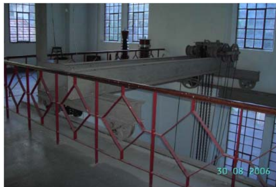
Fig. 27. Puente grúa original. (F. A. Martín). Pont roulant originel. (F. A. Martín)
