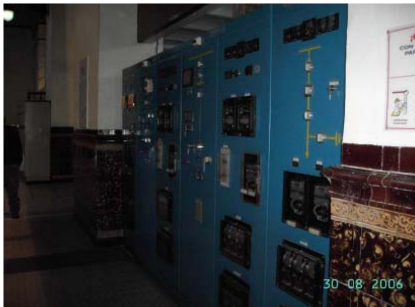
Fig. 30. Cuadro de mandos actual. Obsérvese como se coloca en un hueco existente, sin tener que dañar ni siquiera el zócalo de azulejo. (F. A. Martín).
