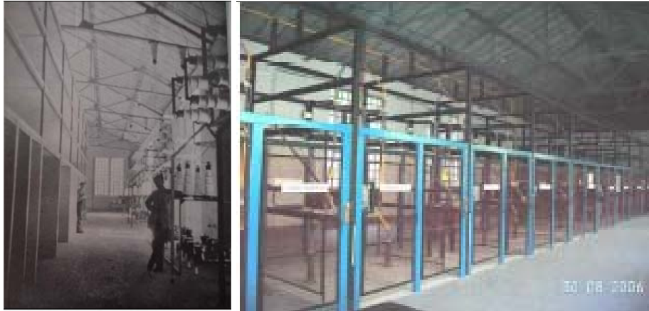
Fig. 26. Izda: Zona de interruptores y seccionadores de alta tensión. Año 1917, Dcha: Celdas de protección de alta tensión. Año 2006. (a) (F. Saltos de agua de Somiedo. Memoria D.) (b) (F. A. Martín). Gauche: Zone d'interrupteurs et sectionneurs d'haute tension. Année 1917, Droite: Cellules de protection d'haute tension. Année 2006. (a) (F. Chutes d'eau de Somiedo. Rapport D.) (b) (F. A. Martín)
