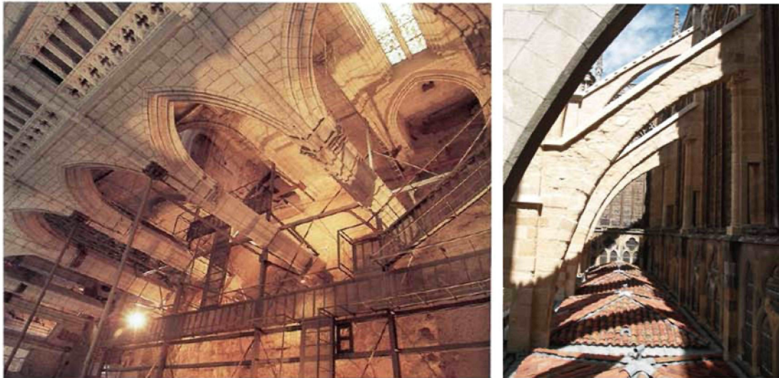
Fig. 21. a) Pasarelas de la Catedral de Vitoria; 21. b) Vista de los tejados de las capillas laterales de la catedral de León desde la plataforma provisional / a) Catwalk in Vitoria Cathedral; b) view of the roofs over the side chapels in Leon Cathedral from the provisional platform
