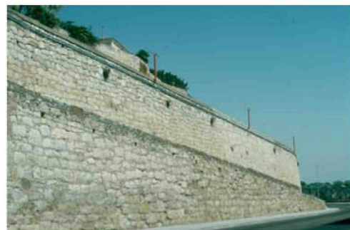
Costanilla practicada en el siglo XVIII en la muralla de Zamora, ejemplo de cómo las ciudades se adecuan a los tiempos / Ramp built alongside the city wall around Zamora in the 18th century. An example of how cities adapt to their times
