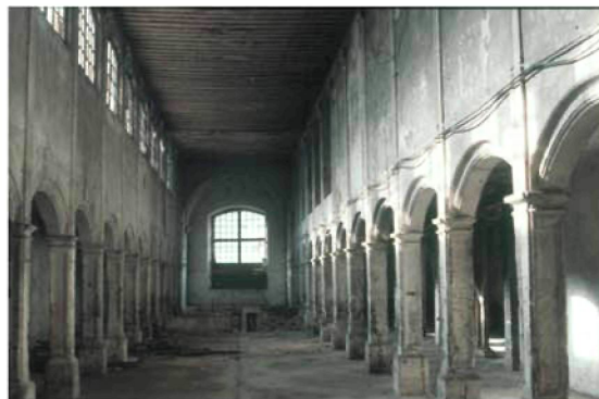
Crujía principal del Hospital de la Concepción de Burgos, antes de las obras de rehabilitación / Main bay in Concepción Hospital at Burgos prior to rehabilitation
