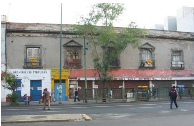
Fig. 1. Estado de la fachada antes de la rehabilitación del inmueble. State of the facade before the rehabilitation of the building.
