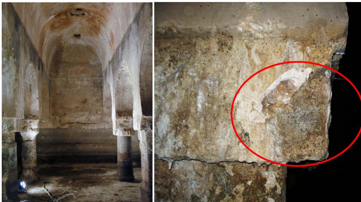
Fig. 8: a) Luceras en la bóveda. Manchas de óxido de hierro. b) Muestra tomada de cimacio sobre soporte de piedra caliza, con pequeñas estalactitas en el borde.
