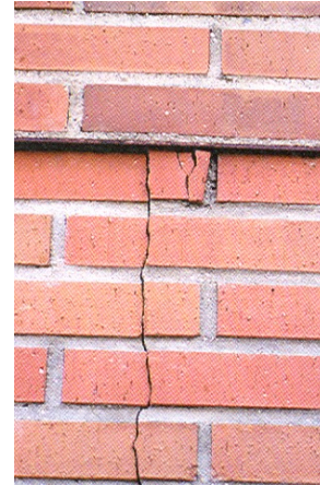
fig. 6 grieta vertical debido a la falta de juntas de dilatación-retracción (vertical crack due to lack of expansion joints) . fotografía AITEMIN
