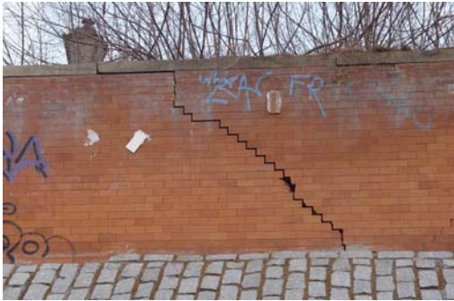
fig. 5 grieta por asiento del terreno (inclined crack due to settling)
