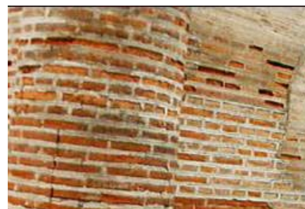
fig. 2 erosión por disgregación producida por criptoflorescencia (erosion produced by cryptoflorescence), Capilla de Luis de Lucena, Guadalajara
