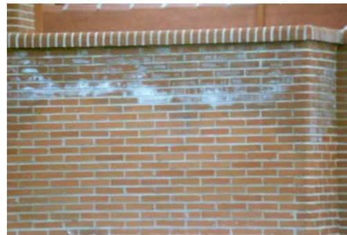
fig. 4 eflorescencia producida por humedad de filtración (efflorescence produced by moisture filtration)
