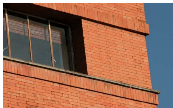
Figura 4: Facultad de Ciencias Físicas, Químicas y Exactas: los sardineles corridos no entestan contra las hiladas.
