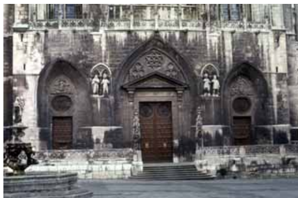
Figura 8. Influencia del diseño de la fachada en el deterioro de la piedra (caliza de Hontoria), en la fachada de Santa María de la Catedral de Burgos.
