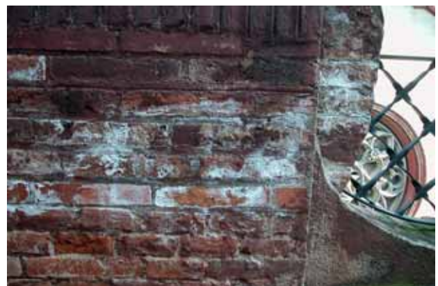
Figura 6. Eflorescencias sobre ladrillos, aparecidas tras un periodo lluvioso, en el Palau de la Música (Barcelona).
