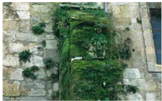
Figura 4. Desarrollo de vegetación (musgos y plantas superiores) en la iglesia de Santa María de Briviesca (Burgos).
