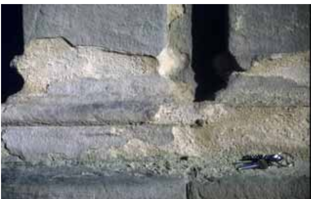
Figura 3. Daños generados por la humedad en el teatro Victoria Eugenia (San Sebastián).
