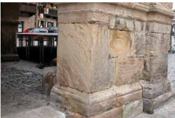
Figura 5. Sillar colocado con la estratificación vertical, mostrando tendencia a exfoliarse, en el Ayuntamiento de Comillas (Santander).
