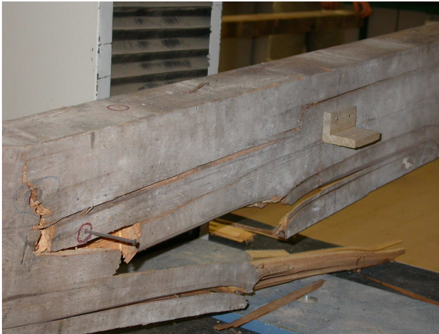
Figura 7. Rotura a flexión de una de las viguetas ensayadas. Rupture to flexion of one of the tested beams.
