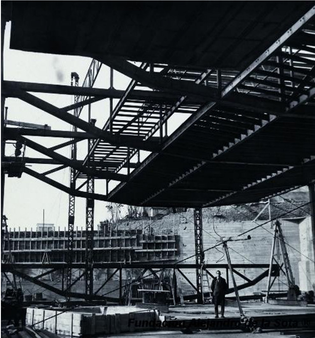
F.05. Fase de construcción del Gimnasio del Colegio Maravillas. Fundación Alejandro de la Sota.
