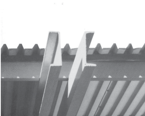
[F23] Vigas sobresaliente de la cubierta de la Casa de Puerta de Hierro. Madrid, 1961
