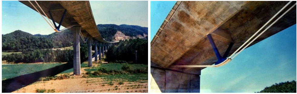
Figura 21: Puente en Osomort, Barcelona, España. 13 vanos de 40 m de luz. Ingenieros: Carlos Fernández Casado SL. 1994-95. (© Jose L Fernandez Cabo).
