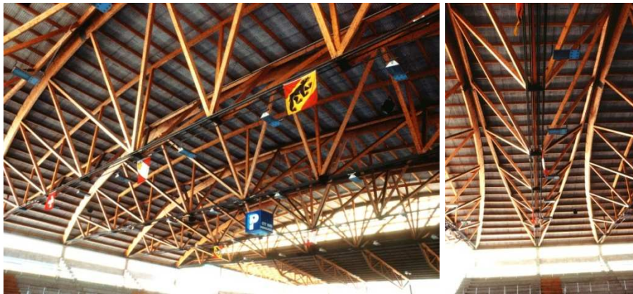
Figura 30: Cubierta de polideportivo de 60 m de luz, resuelta con vigas bowstring de madera y acero (© Jose L Fernandez Cabo).
