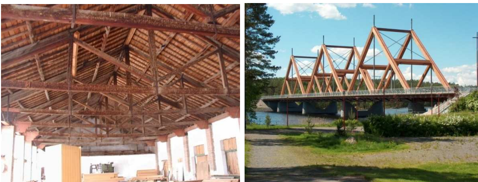
Figura 20: Cubierta del aserradero de Valsaín (izquierda), Segovia, España; Puente Vihantatalmi, Finlandia (derecha). (© Jose L Fernandez Cabo).
