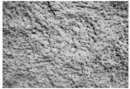
Fig. 3 Textura del hormigón picado del interior de la Iglesia del Santísimo Redentor: Fernando Menis. 2004
