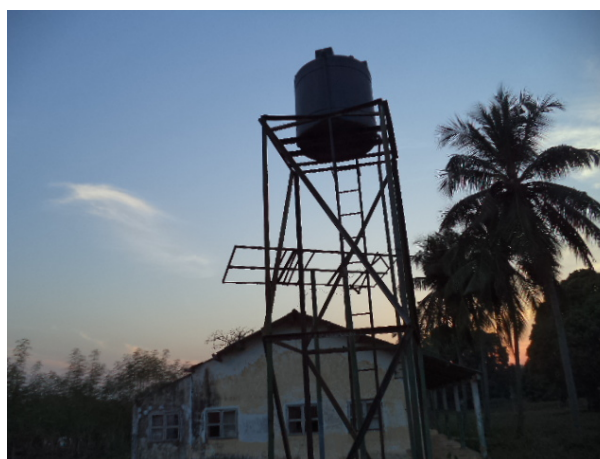
Figura 7. Bombeo con los paneles desaparecidos en Bolama Guinea Bissau (AIDA asociación).
