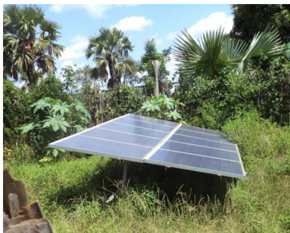
Figura 3. Instalación solar cayendo poco a poco en el olvido. Las sombras y la maleza comienzan a cubrir los paneles. Niel, Sur Sudan (Oxfam GB).
