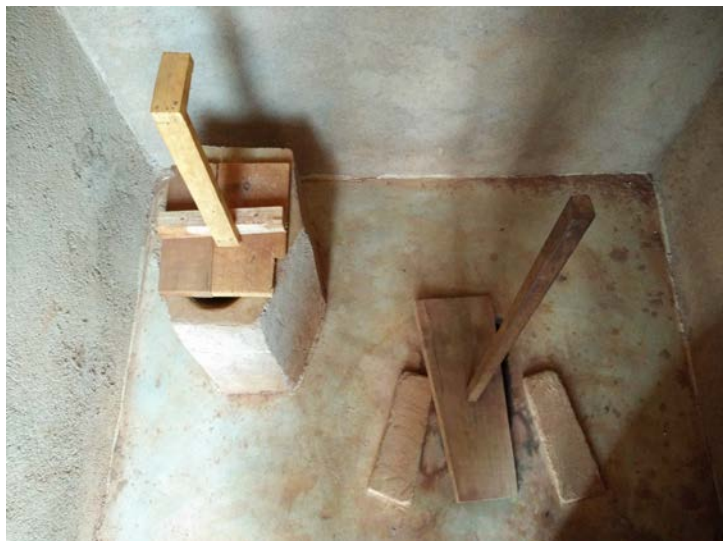
Figura 9. Losa UPIMIDI instalada en una letrina de Kongwa Fuente: Ana Esteban Zazo
