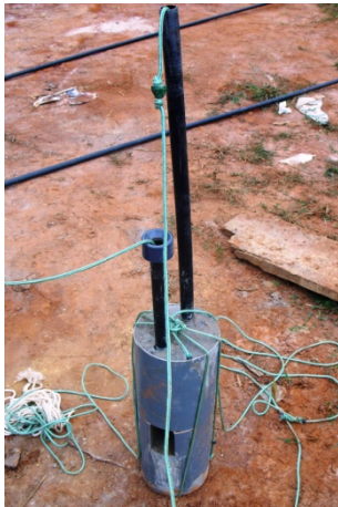
Figura 18. Tubería macizada inferior.
