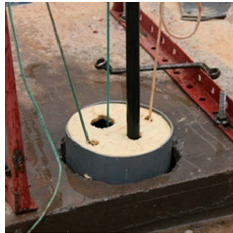
Figura 19. Tapa de la tubería de encamisado.
