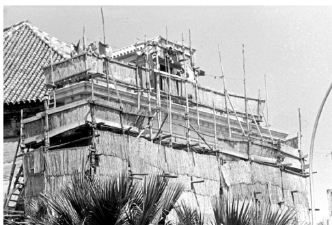
Figura 12. Ejecución de la buhardilla, cornisa y elementos de remate de la fachada sur. Fuente: © ICAS-SAHP. Fototeca Municipal de Sevilla, fondo Serrano. Capilla de San Hermenegildo en obras. Exterior. Remate. 1963.
