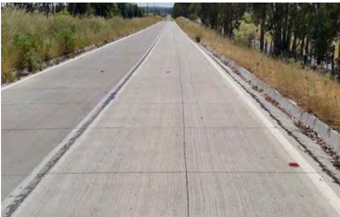
Fig. 13. Aplicación de la tecnología de Pavimento de Hormigón de losa corta con Fibras. Espesor 8cm, colocado directamente sobre el terreno natural nivelado. Fuente: http://vialidadytransporte.com .
