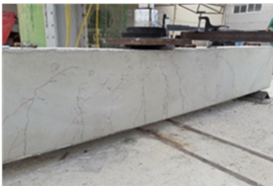
Fig. 22. Inspección visual de las fisuras.
