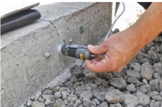
Fig. 7. Medición del ancho de grieta con microscopio. Fuente: [8].
