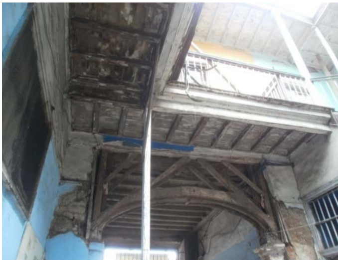
Figura 12: Estructura del pasadizo interior. Fotografía tomada por Sandra Olmos, Fanny Centeno, Erika Ampuero y Lily Campos para la asignatura Restauración de Monumentos- UNFV.
