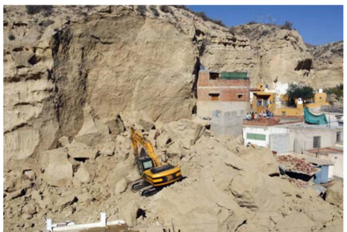
Figura 4: Trabajos de desescombro tras el accidente en casa cueva en Cuevas del Almanzora. Fotografía realizada por el autor.
