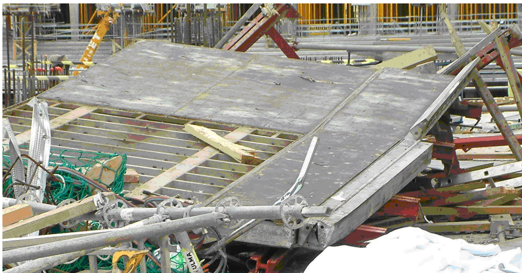
Figura 2: Estado final encofrado vertical trepante siniestrado durante ejecución estructura vertical de hormigón armado.
