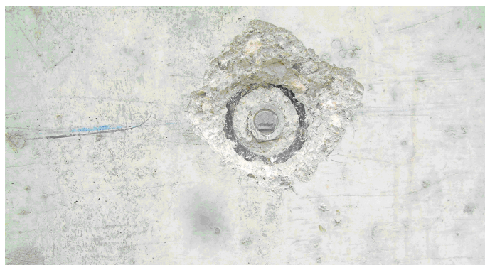
Figura 6: Estado zona del anclaje fracturado.
