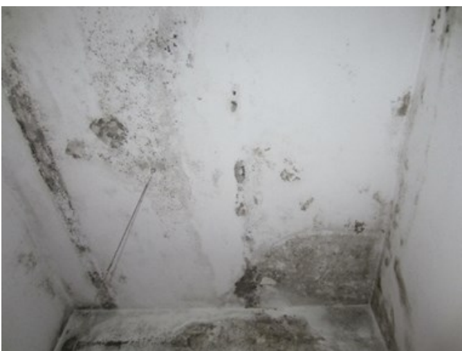
Figura 2: Imagen del estado enmohecido del techo del baño.
