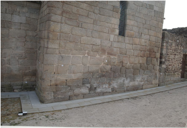
Fig. 6. Fachada norte con signos evidentes de patología por humedad y eflorescencias salinas
