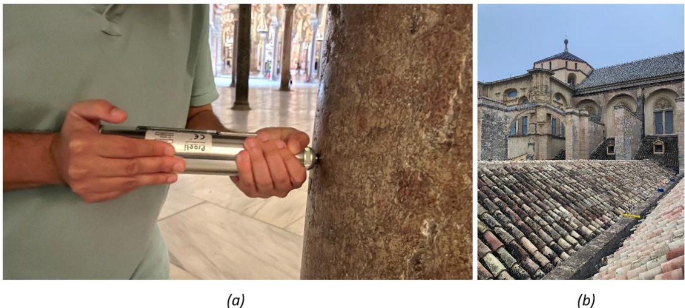
Fig. 5. (a) Realización de un ensayo con el esclerómetro sobre una de las columnas del sector. (b) Medición de las vibraciones ambientales con acelerómetros triaxiales sobre las arcadas para el posterior OMA.
