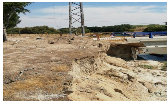
Fig. 4. Continúa de lo expuesto en la figura 3. Daños causados a un puente y a un apoyo de línea eléctrica de media tensión. (Fuente: Ayto. de Getafe).
