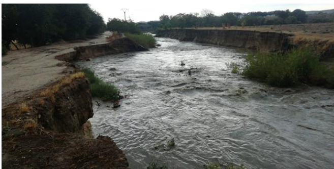
Fig. 3. Vista del Arroyo Culebro aguas abajo de la obra de salida de la EDAR tras la DANA de 2018. Previamente, el ancho del cauce, en el fondo, rondaba los 6 – 8 metros. Tras la DANA, se alcanzaron los 40 metros en algunos puntos. A la izquierda de la imagen se observa que casi quedó completamente cortado el único camino de acceso a multitud de fincas, que, de otra forma, sólo hubieran podido acceder desde Rivas – Vaciamadrid (Fuente: Ayto. de Getafe).
