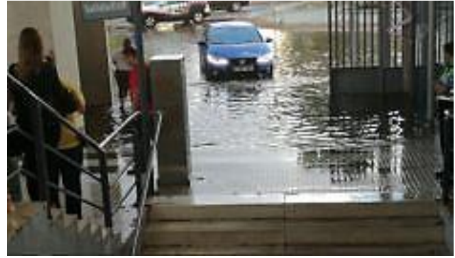
Fig. 6. Frecuentes inundaciones de una estaci3n de Cercan3as Madrid a causa de la insuficiencia de sus sistemas de drenaje. (Fuente: Twitter).
