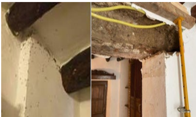
Fig. 1. (a) Ataque de termitas detectado en una vivienda particular en Albuñuelas (Granada); (b) Obras destinadas a sustituir las vigas dañadas.
