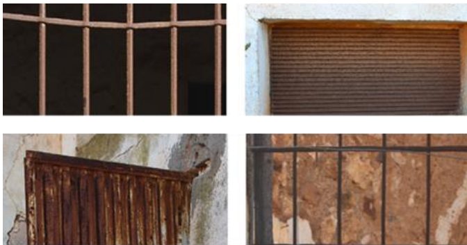
Fig. 8. Elementos oxidados en el Cortijo del Fraile. Fotografías de las autoras, 2018.
