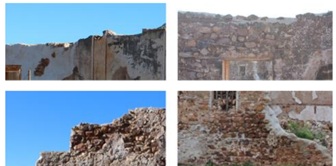
Fig. 3. Ejemplos de pérdida de material en el Cortijo del Fraile. Fotografías de las autoras, 2018.
