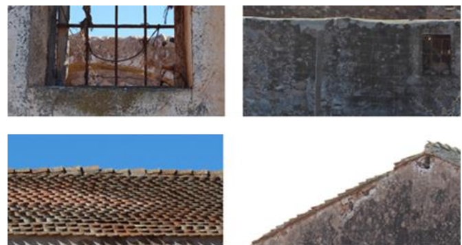
Fig. 6. Hongos en los paramentos y líquenes en las cubiertas del Cortijo del Fraile. Fotografías de las autoras, 2018.
