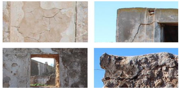
Fig. 5. Fisuras en el Cortijo del Fraile. Fotografías de las autoras, 2018.
