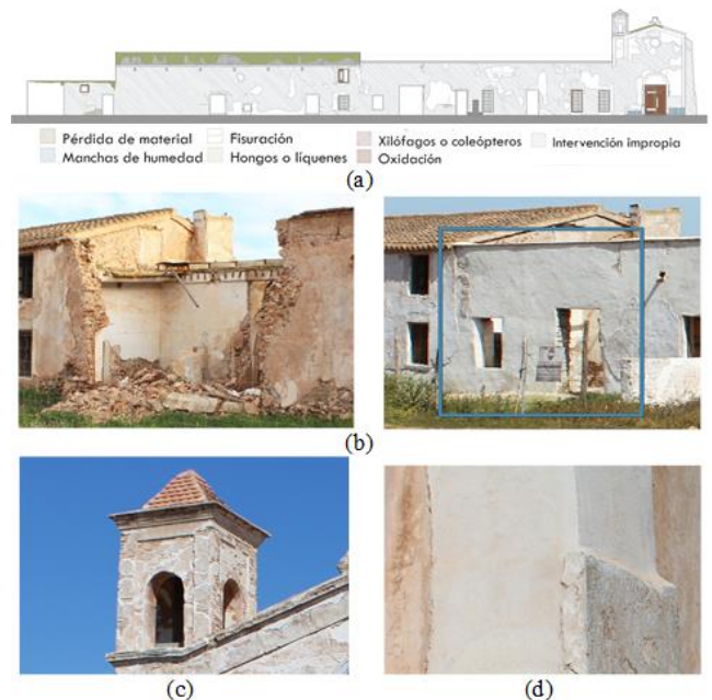
Fig. 10. (a) Mapa de lesiones de la fachada suroeste. Elaboración propia. (b) Reconstrucción de muro derrumbado (c) Tejas semicirculares de la torre campanario. (d) Consolidación de estribo en zonas con pérdida de sección. Fotografías de las autoras, 2018.
