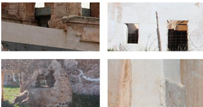
Fig. 9. Elementos impropios de las intervenciones de conservación y consolidación de 2015. Fotografías de las autoras, 2018.
