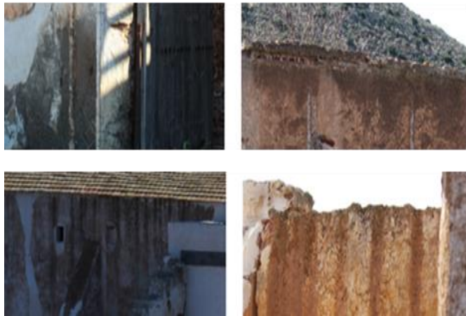
Fig. 4. Manchas de humedad en elementos constructivos del Cortijo del Fraile. Fotografías de las autoras, 2018.
