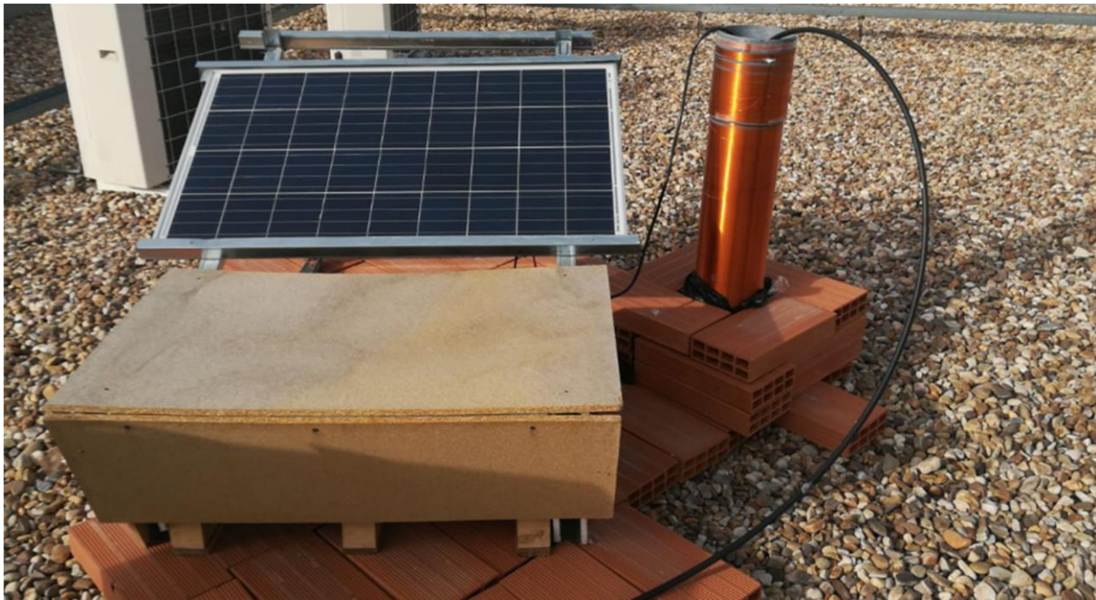
Fig. 9. Instalación fotovoltaica y depósito para riego de la cubierta ajardinada automatizada.
