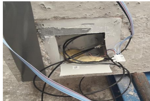
Fig. 8. Terminales de fibra óptica en caja de registro embebida en la viga.
