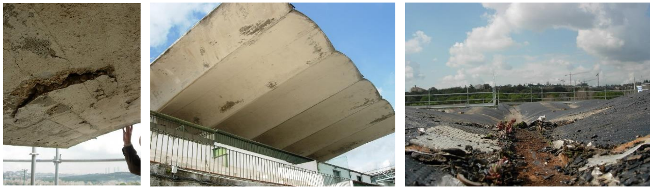
Fig. 2. Estado de las cubiertas en la parte superior e inferior.
