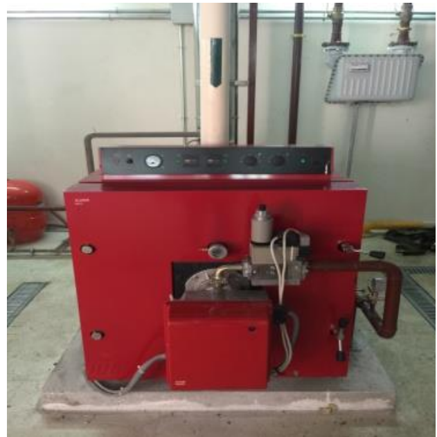
Fig. 13. Caldera de la instalación de 43 captadores.
