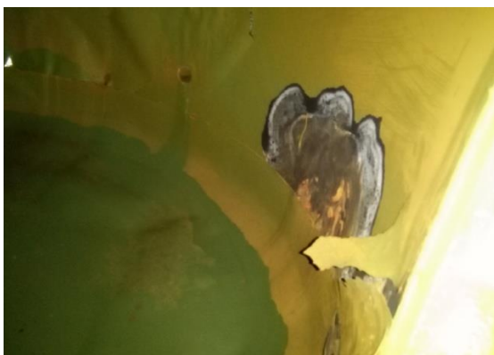
Fig. 9. Estado deteriorado de un depósito de acumulación por falta de protección frente a la corrosión.
