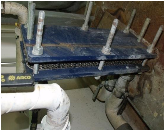
Fig. 11. Grupo de intercambio deteriorado por el tiempo.
