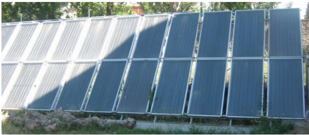
Fig. 5. Bloque de captadores mal situados.
