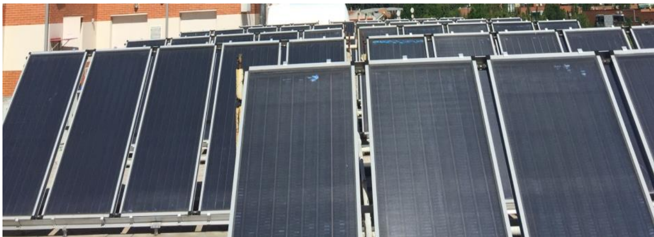
Fig. 1. Instalación solar térmica de captadores de placa plana. Salesianos Carabanchel.
