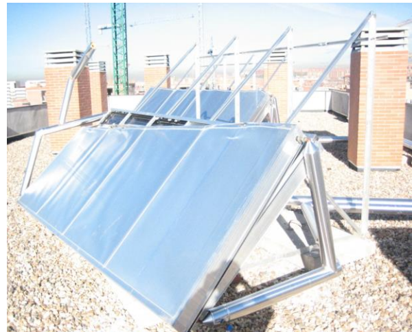
Fig. 3. Caída de captadores por acción del viento debido a una mala fijación de los anclajes.
