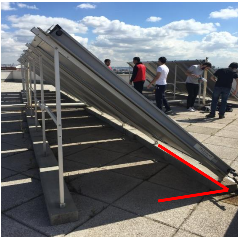
Fig. 2. Ejemplo de captadores sobre cubierta plana.
