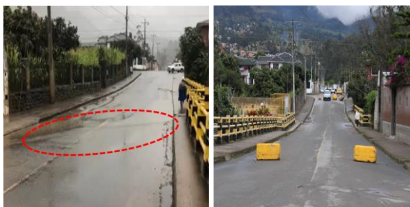
Fig. 1: Asentamiento de calzada estribo izquierdo y restricción del tráfico vehicular pesado. Elaborado por: Autores.
