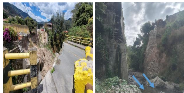
Fig. 2: Colapso del puente de la calle Arturo Sandez y Estribo derecho sin afecciones. Elaborado por: Autores.
