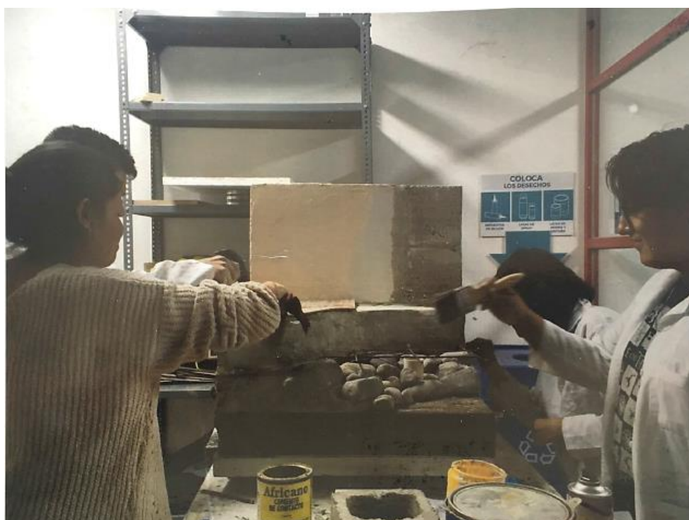
Fig. 8. Sensibilización del material e instalación en la construcción. Taller de Construcciones III-2017. Fuente: Gabriela Mejía Gómez
