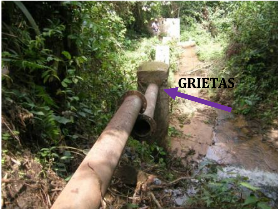
Figura 6. Grietas producidas por las vibraciones de la bomba de ariete Hydrum Bkake.
