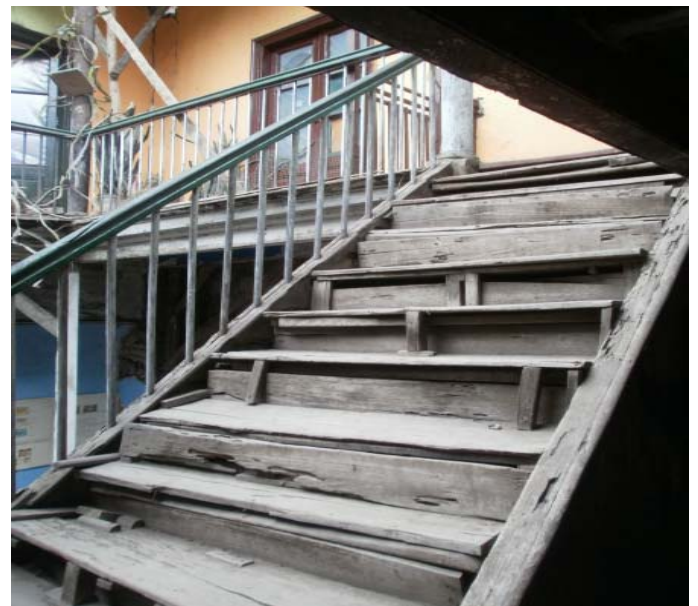
Figura 14: Estado de la escalera interior. Fotografía tomada por Sandra Olmos, Fanny Centeno, Erika Ampuero y Lily Campos para la asignatura Restauración de Monumentos - UNFV.
