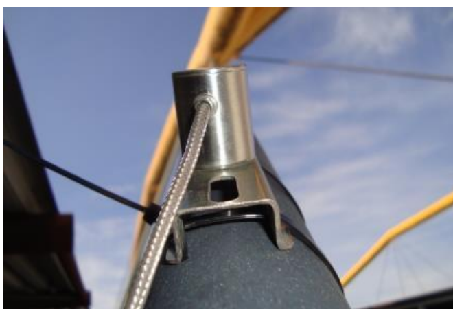
Fig. 4. Sensor instalado en un tirante (fuente: Acciona Ingeniería S.A.).
