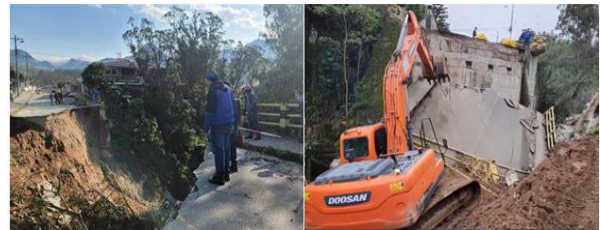
Fig. 2: Colapso de Puente de la Calle Arturo Sandez el 20 de febrero del 2022
