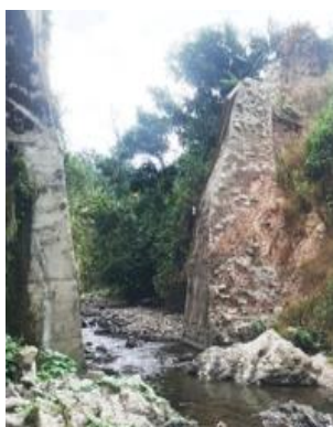
Fig. 3: Puente colapsado. Vista desde aguas abajo. A mano derecha se observa el estribo izquierdo.
